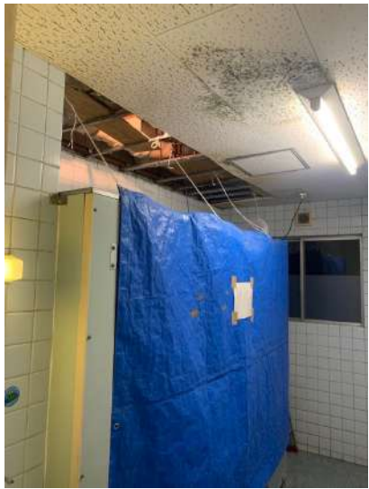
2022年8月、本庁舎1階男子トイレの天井が一部崩落。深夜時間帯だったため、市民や職員もおらず。人的被害を免れたのは不幸中の幸い
