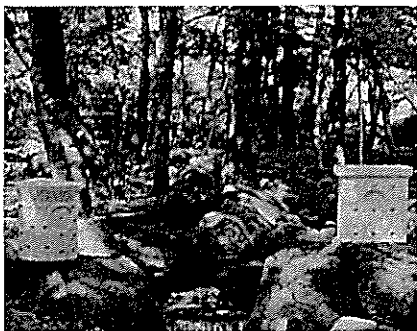
多孔型浸透ます
